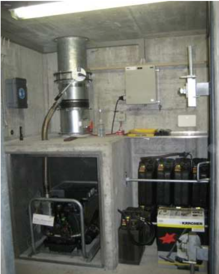
A 3835 Roost, Nische mit Notstromaggregat und Betriebsstofflager mit Kanistern
