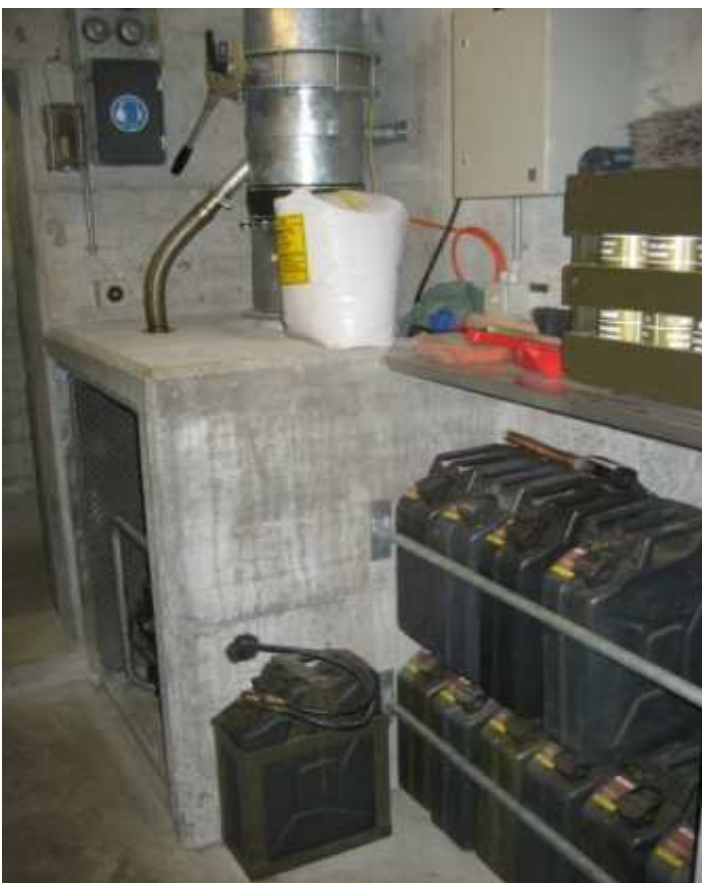
A 6182 Schollberg Nord, Nische mit Notstromaggregat und Betriebsstofflager mit Kanistern
