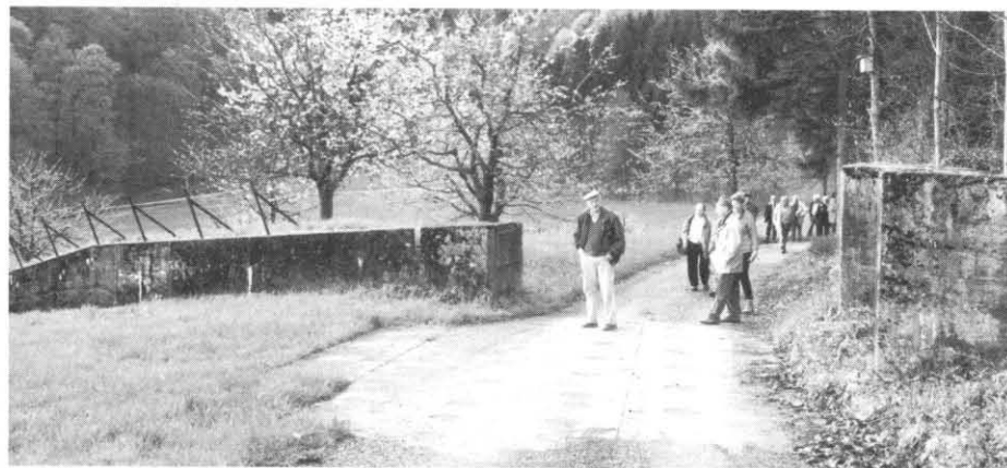
Die geknickte Tankmauer südlich von Oberhof AG
