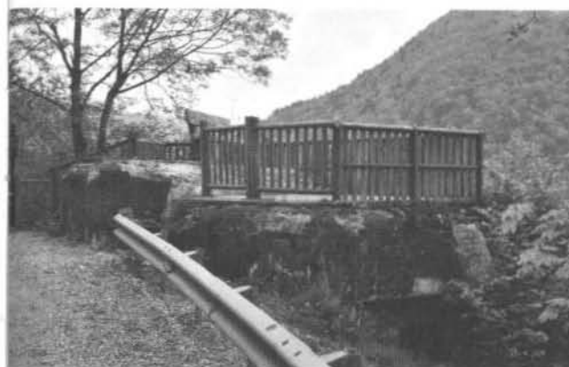
Ein baufälliger französischer Bunker bei Goumois (F)
