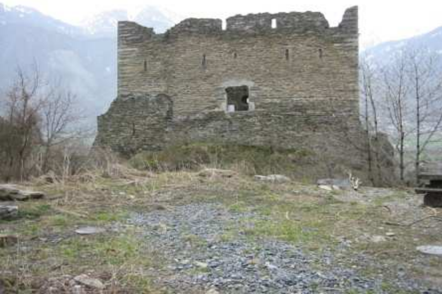
A 6329 Neuenburg, Scharten mit Metallplatten verschlossen
